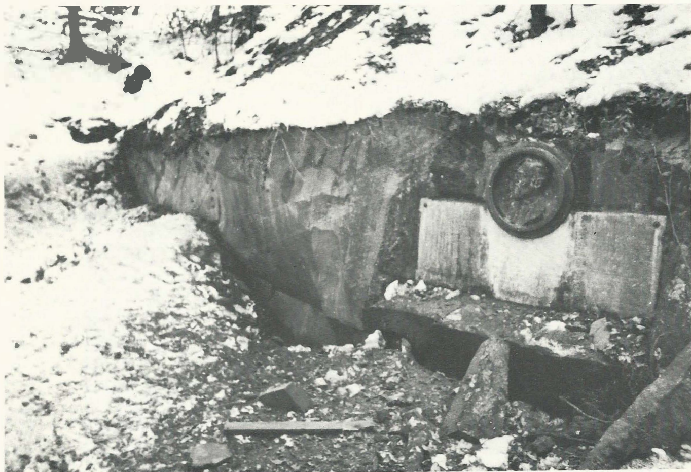
État actuel photographie de lendemain de l'effondrement par temps de neige. A gauche du médaillon et de la plaque MER WART, intacts, le banc rocheux s'est affaissé sur le sable, obstruant totalement l'ancienne entrée de la caverne. (Photo «République de Seine-et-Marne»).
