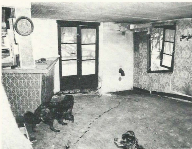
Au-dessus de la caverne, dans la «Tavernedela Croix-d'Augas», l'intérieur de la salle de restaurant affaissé de 0,80 m. Sol fissuré, murs et fenêtres disloqués. (Photo «République de Seine et Marne»).
